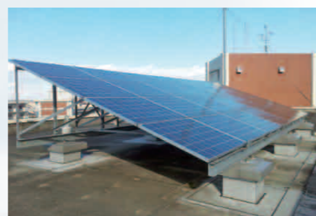
都営アパートの太陽光パネル
