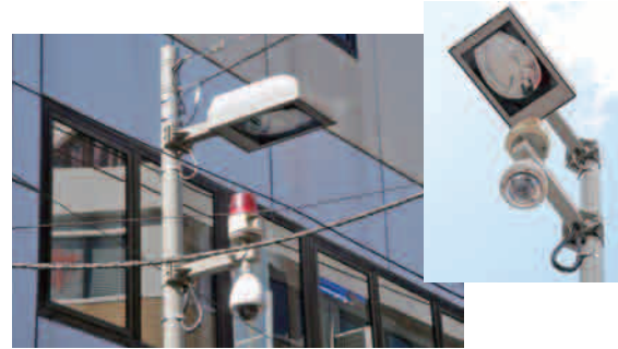
町田駅周辺に設置されたスーパー防犯灯
